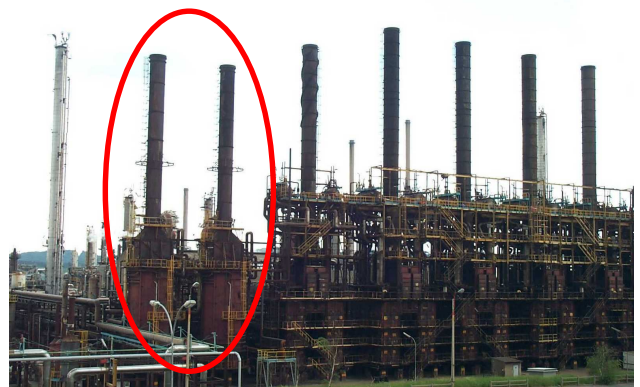
Figure 2 : Vue des deux surchauffeurs de l'unité (DR)
