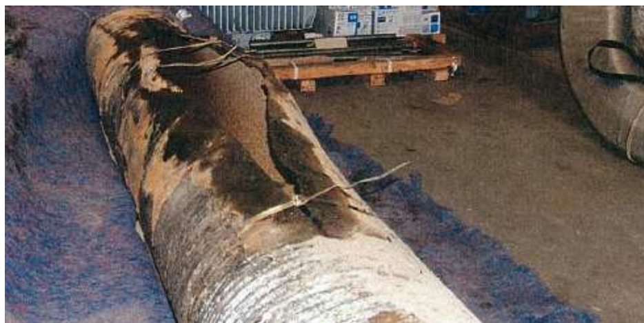
Partie endommagée – DREAL PACA
