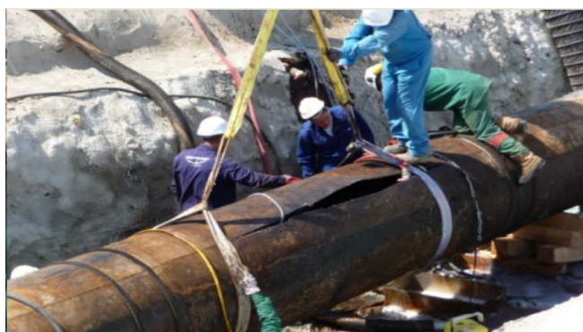
Rupture "boutonnière" du pipeline de 40 pouces (D.R.)
