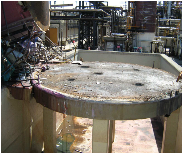
Photos DREAL : socle en béton sur lequel reposait le bac
