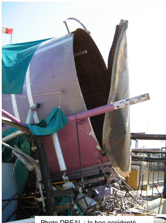
Photo DREAL : le bac accidenté
