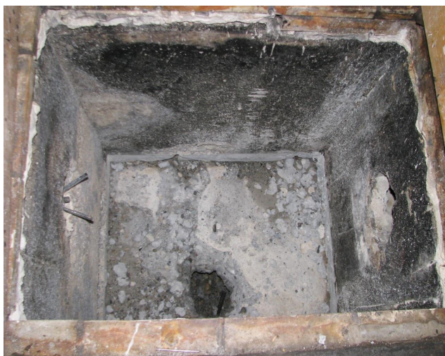
Cuve d'effluents chimiques endommagée © Exploitant
