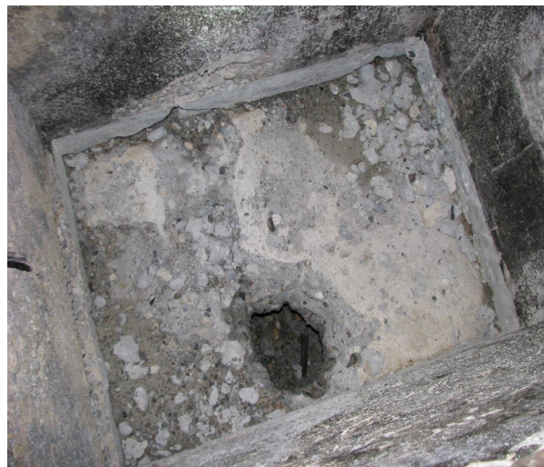
Trou dans le fond de la cuve d'effluents © Exploitant
