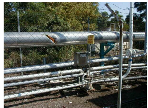
Impact d'un éclat sur une canalisation de vapeur d'eau
