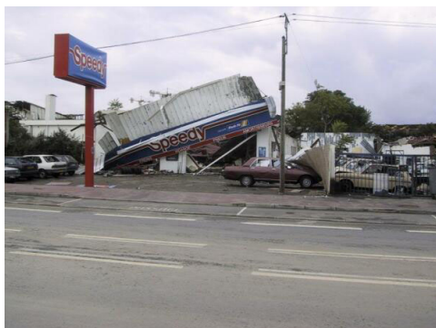
Etablissement d'entretien de véhicules détruit
