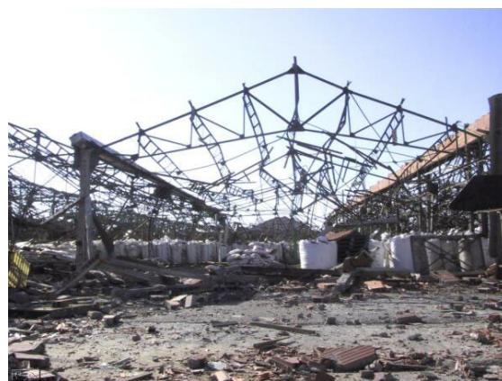
Entrepôt dévasté par l'explosion
